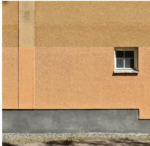
Slät puts på sockel. Avvikande kulör på bottenvåningen.
